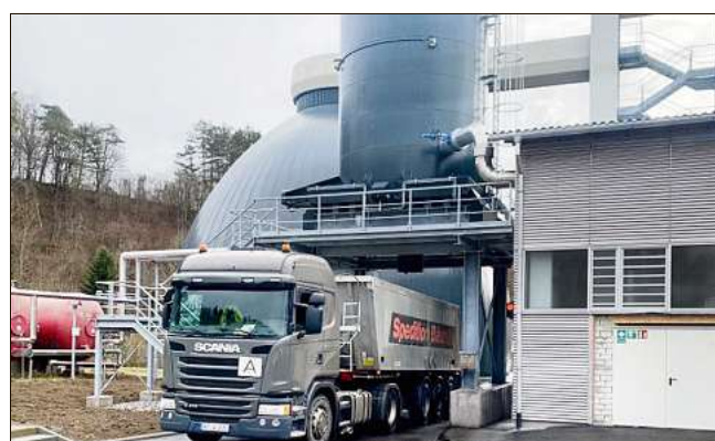
Durch die neue Klärschlammverladestation verläuft die Beladung der Transportfahrzeuge deutlich komfortabler und effektiver. Foto: ENRW
